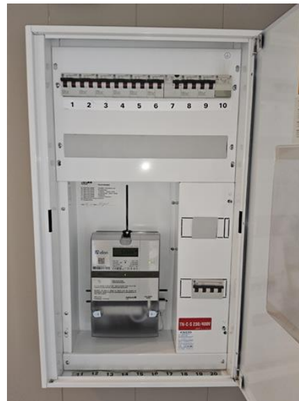
Elektrisk anlegg - [Sikringsskap.]
