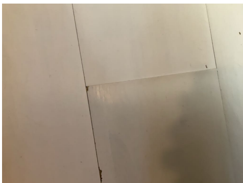
Synlig svell i skjøter
