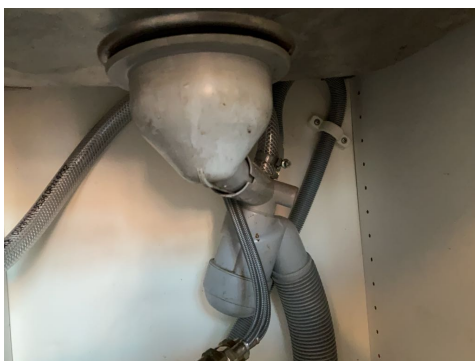
Vannrør i kjøkkenskap
