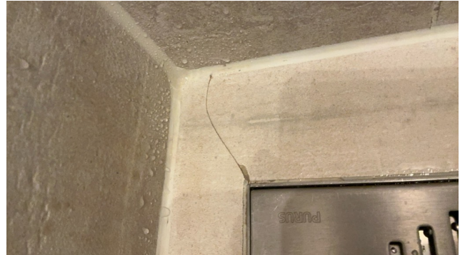
Sprekk i flis hjørne dusjsone
