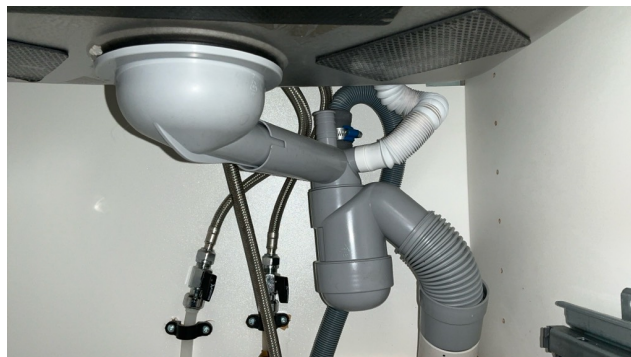
Avløp vask kjøkken
