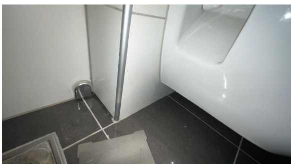
Drensspalte til venstre for toalettsisternen.
