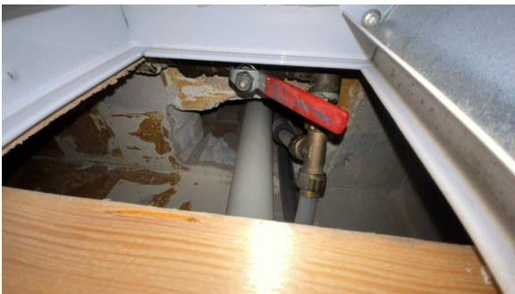
Vanskelig å vurdere rør innenfor inspeksjonsluken.
