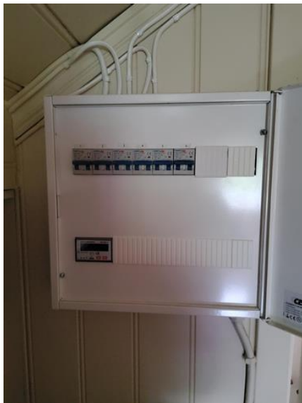
Elektrisk anlegg - [Sikringsskap 2.etasje ]
