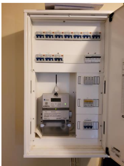
Elektrisk anlegg - [Sikringsskap 1.etasje ]
