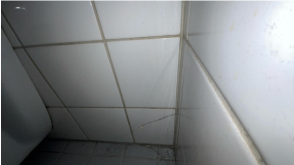
Sprekker i fliser
