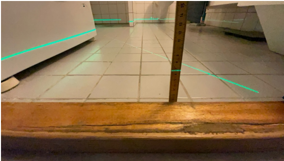
Høydeforskjell (flis ved terskel)
