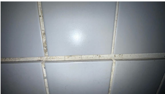
Riss i fuger
