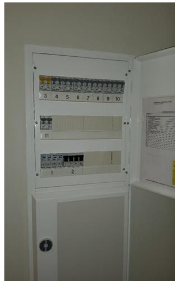
Elektrisk anlegg - [Sikringskap ]
