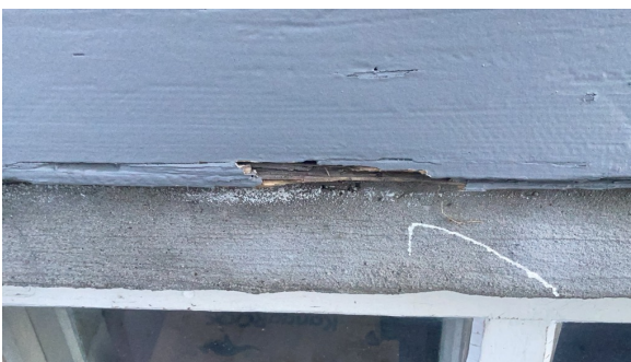
Råteskade i panel.
