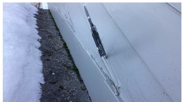
Råteskade i panel.
