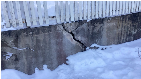
Sprekker i støttemur.
