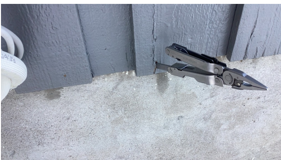
Råteskade i panel
