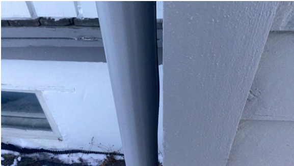
Frostspreng på takrennedeløp.
