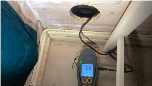
Ved fuktmåling registrerte jeg tørre verdier.
