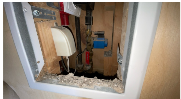
Magnetventil for lekkasjestopper er synlig innenfor liten inspeksjonsluke i garderobeskap på soverom.
