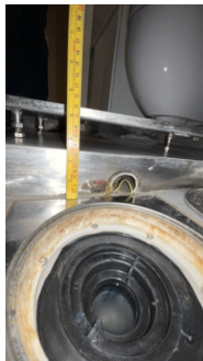
Sluk er nedsenket i forholdet til gulvflaten.
