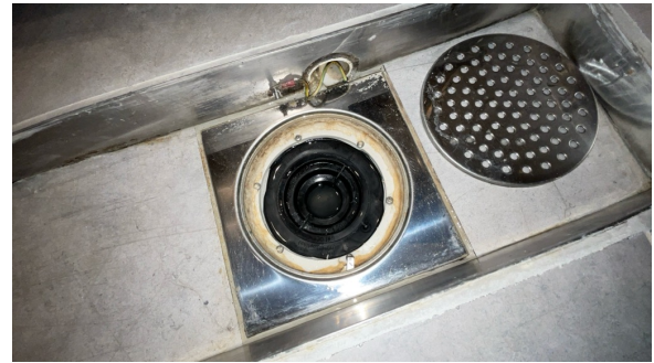
Sluk er nedsenket i forholdet til gulvflaten.
