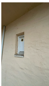
Avtrekksvifte er ført gjennom vindu i yttervegg.
