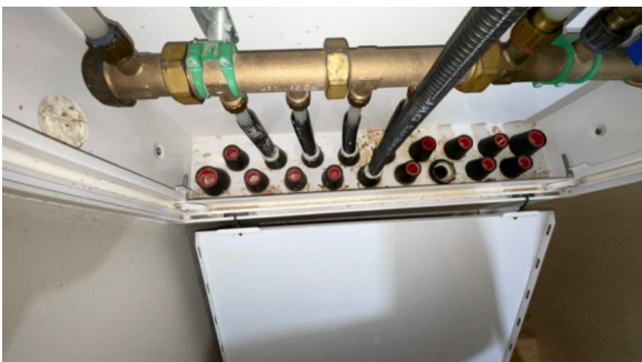
Synlig avrenningshull inni fordelerskap.
