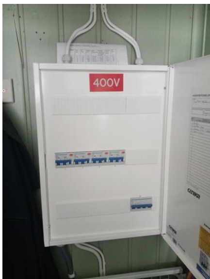
Forenklet vurdering av det elektriske anlegget - [Sikringsskap]
