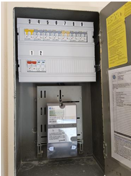
Elektrisk anlegg - [Sikringsskap]
