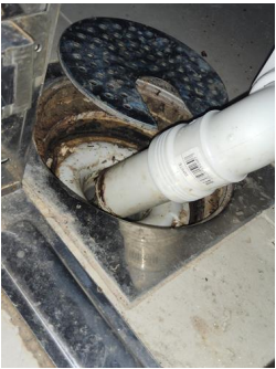
Vanntett sjikt / membran i gulv og vegger - Sluk badekar bad 2
