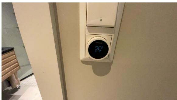
Termostadbryter til varmekabler.
