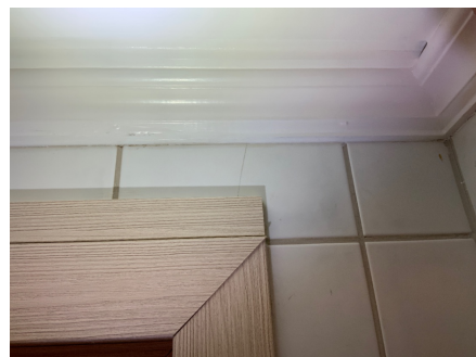
Sprekk i flis utenfor våtsone
