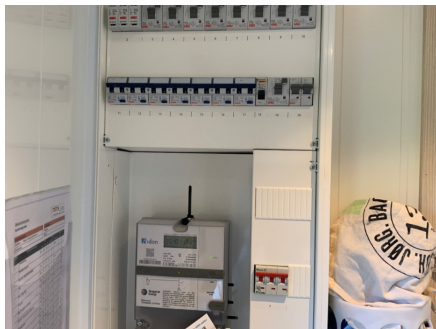
Sikringsskap i vaskerom
