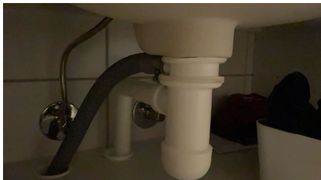
Avløp servant bad
