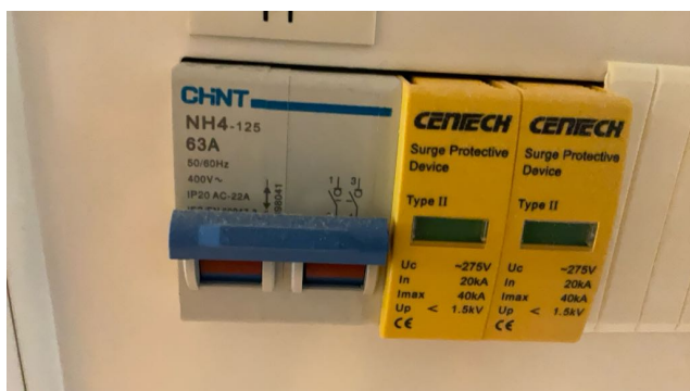
Hovedsikring på 63 amp
