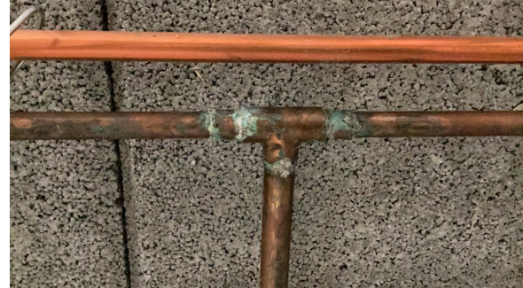
Irr på rør.
