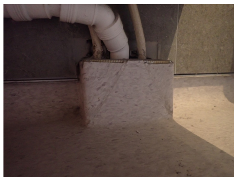
Avløp fra dusjkabinett til sluk ved servantskap
