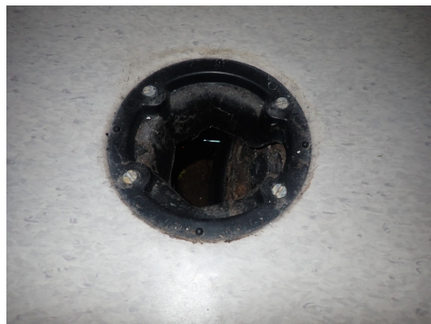
Sluk på gulv ved servantskap.
