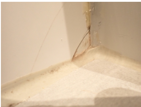
Flis i hjørne mot gulv og dusjvegg har sprukket
