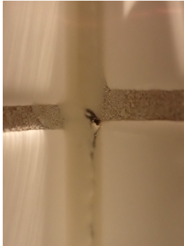
Det er riss og sprekker i fuger overgang vegg/vegg
