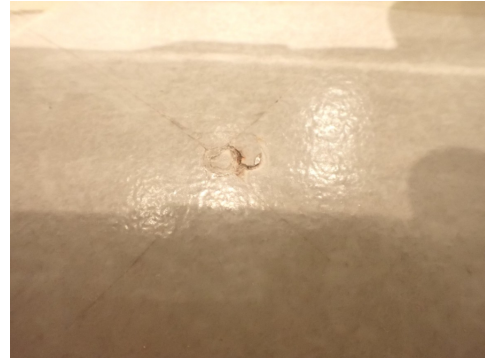
Flis på gulv i dusj har sprukket
