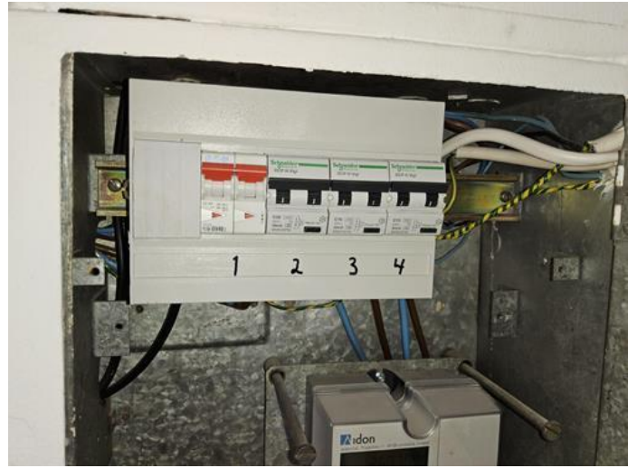
Elektrisk anlegg - [Sikringskap ]
