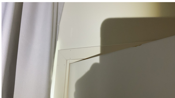
Sprekk over dør på soverom.
