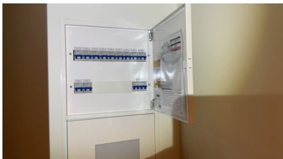
Sikringsskap i entre.
