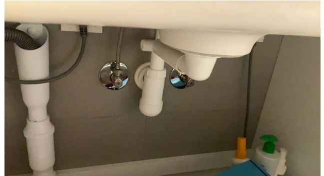
Avløpsrør servant bad
