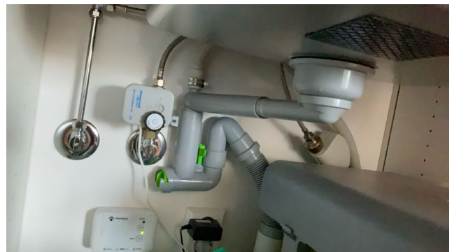
Avløp vask kjøkken
