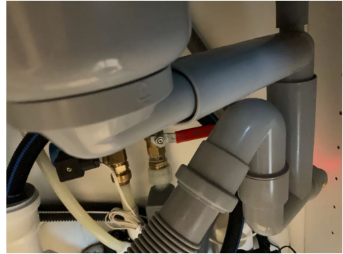
Avløp vask kjøkken
