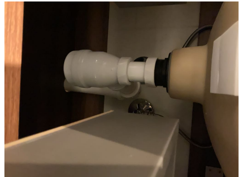
Avløp servant bad
