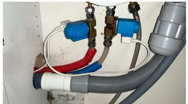
Vann rør og automatisk lekkasjeikring i kjøkkenskap
