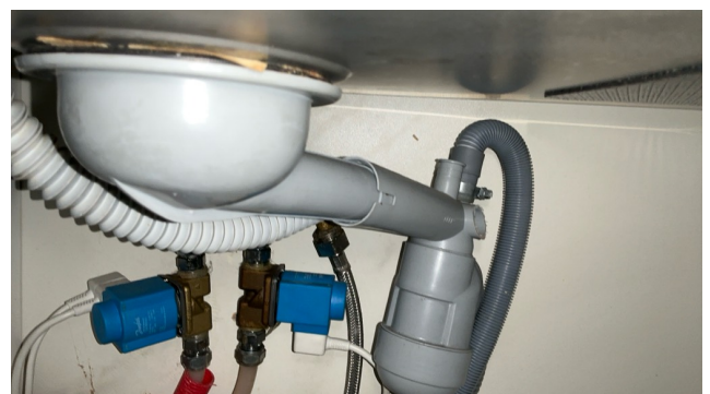
Avløp vask kjøkken
