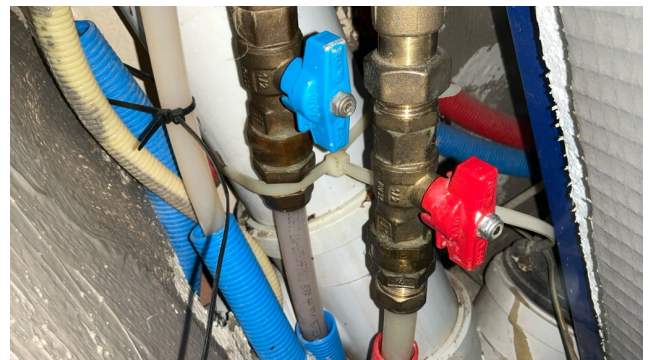
Hovedstoppekraner bak kjele i vegg bad.
