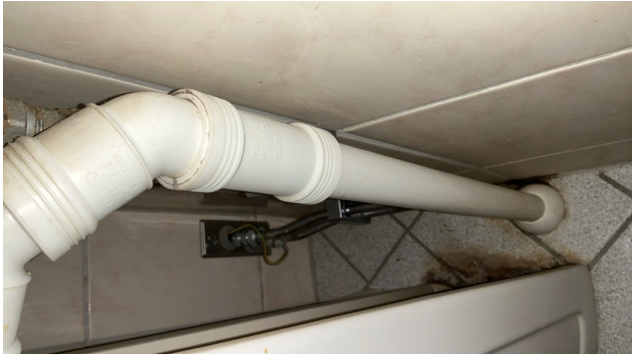
Avløp servant bad
