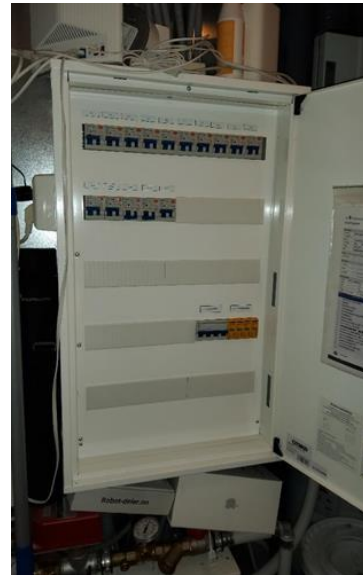
Elektrisk anlegg - [Sikringsskap ]
