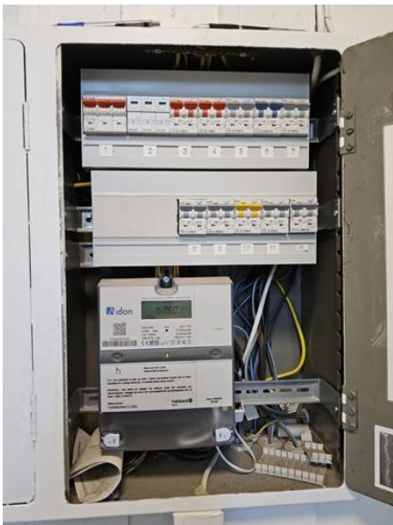
Elektrisk anlegg - [Sikringskap]
