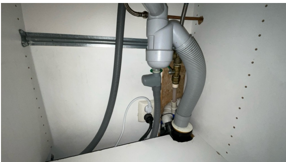
Rørproplegg på kjøkken.
