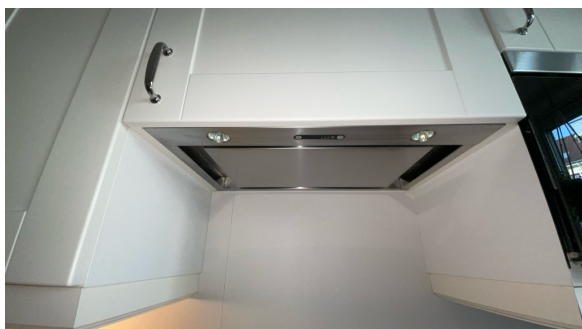
Kjøkkenventilator med kullfilter.
