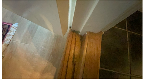
Luftespalte under dørbildet.
