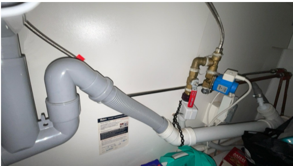
Røropplegg på kjøkken.
