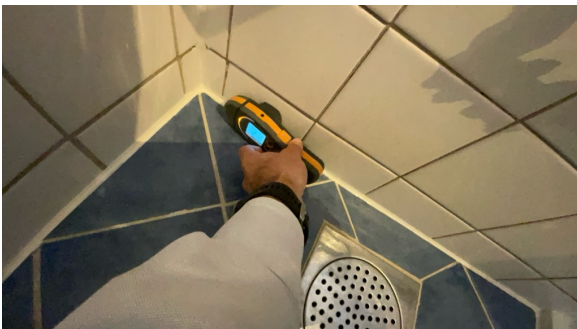
Protimeter fuktapparat gjorde utslag ved tilfeldig fuktsøk langs sokkel i dusj.
