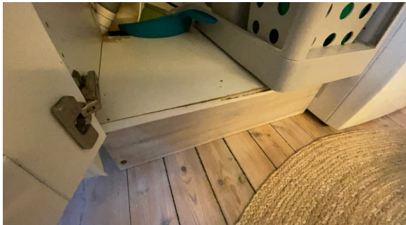
Svelling i underskap.
