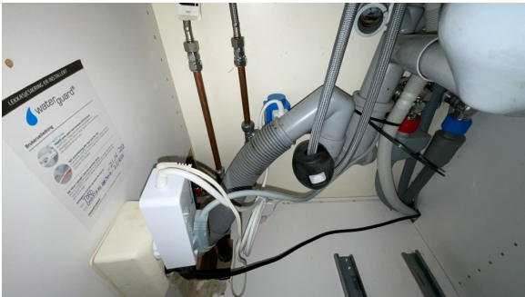
Vannrør på kjøkken.
