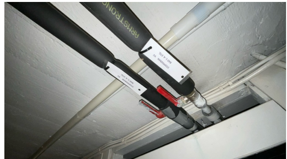
Felles hovedstoppekran i felles kjeller.
