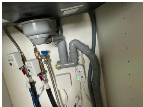
Avløp vask kjøkken
