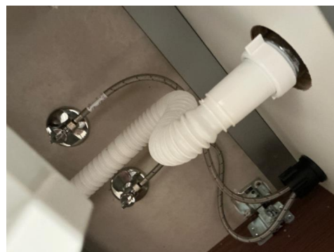
Avløp servant bad
