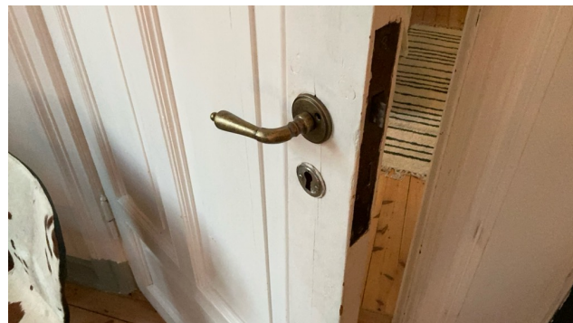
Synlig slitasje overflater
