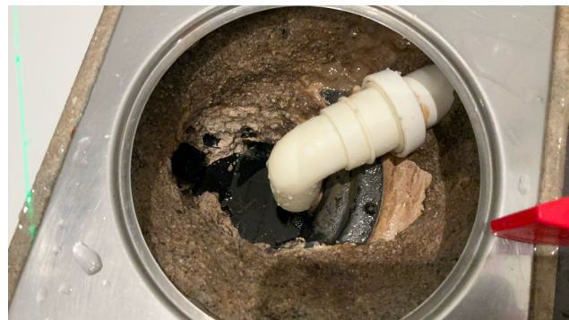
Sluk i dusjsonen
