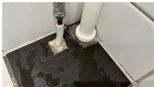
Gjennomføringer i gulv dusjsone.
