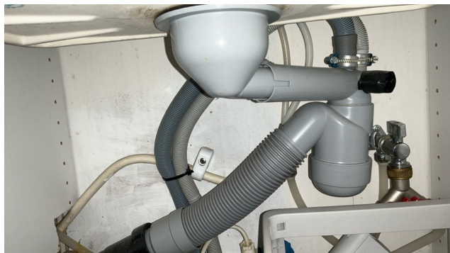
Avløp kjøkken vask
