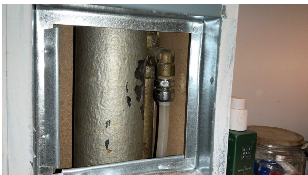
Hovedtilførsel vann kjøkken bak luke vegg over kjøkkenbenk.
