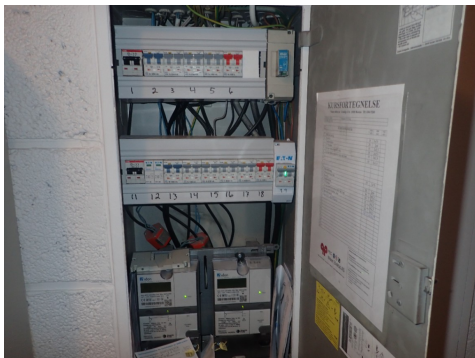
El-skap plassert i fellesareal gang. F
