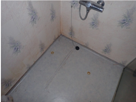
Gulvbelegg har synlige skader i dusj.
