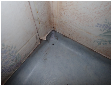
Tapet har løsnet og er misfarget
