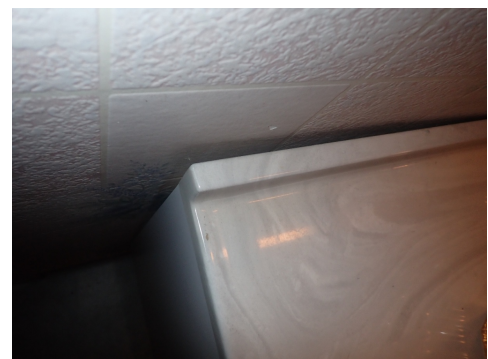
Servantskap har løsnet fra vegg.
