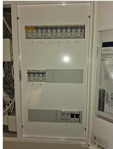
Elektrisk anlegg - [Sikringskap. ]
