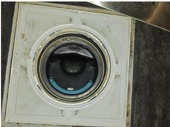
Avløpsrør (ink. sluk) - [Sluk bad]
