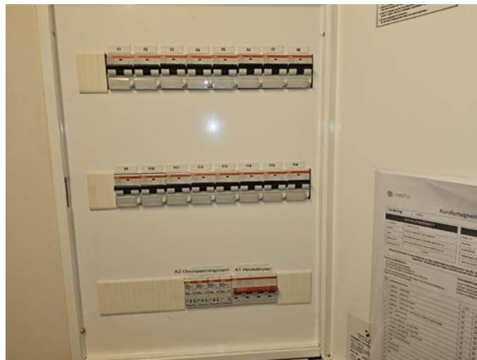
Elektrisk anlegg - [Sikringskap]
