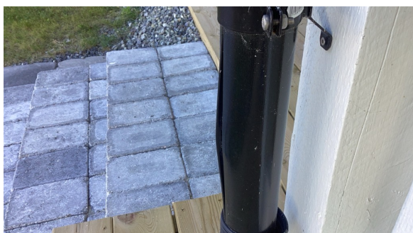
Frostspreng på takrennedløp.
