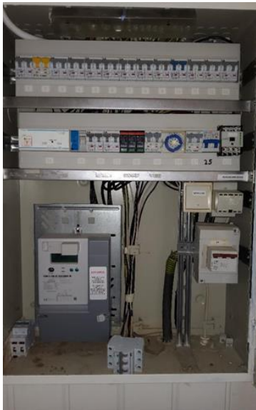
Elektrisk anlegg - [Sikringsskap]
