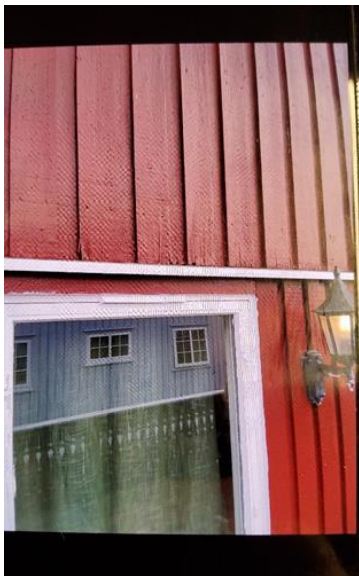
Yttervegger inkl. fasader og konstruksjon - [Råteskader yttervegg]
