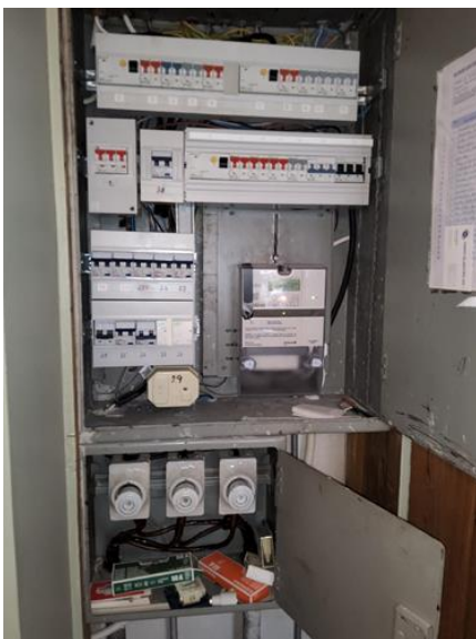
Elektrisk anlegg - [Sikringskap]
