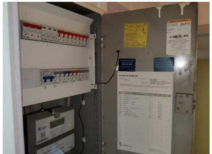
Elektrisk anlegg - [Kursfortegnelse.]
