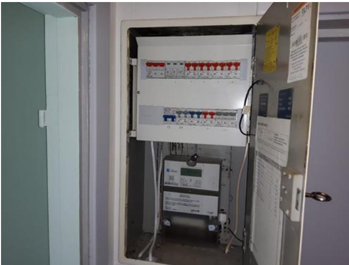
Elektrisk anlegg - [Sikringsskap. ]
