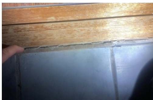
Løse fliser mot dørterskel.
