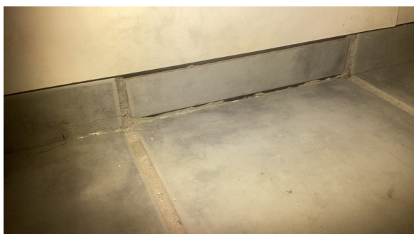
Manglende membran i overgang terskelflis og våtromspater i våtsone
