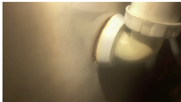
Rørgjennomføring i våtromsplate i våtsone uten mansjett.
