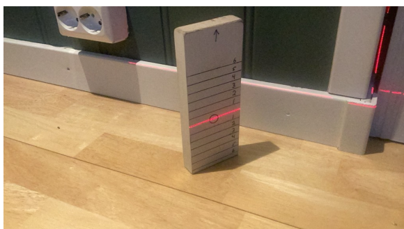
Soverom mot gårds plass, overflateavvik.
