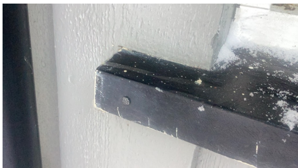
Ingen klaring mellom omramming og vannbrett.
