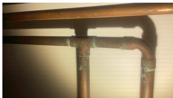
Irr på rør.
