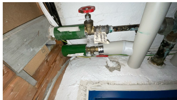
Felles stoppekranner i felles kjeller til alle kjøkken i oppgangen.
