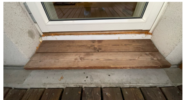
List/beslag mangler under dørterskelen.
