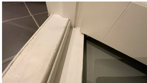
Luftespalte under dørbildet.
