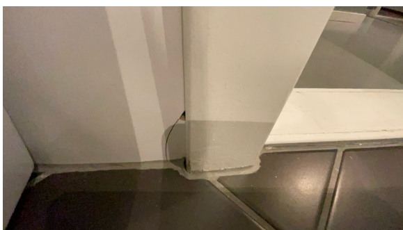
Sprekk i flis.
