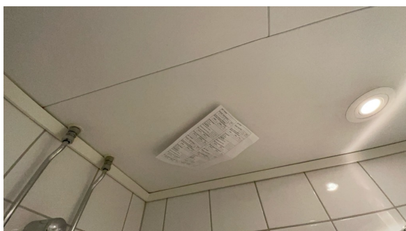
Test med løst ark viste tilfredstillende avtrekk.
