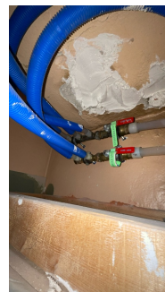
Plastrør og stoppekranner over himling på badet.
