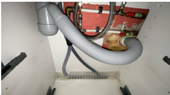
Rør på kjøkken.
