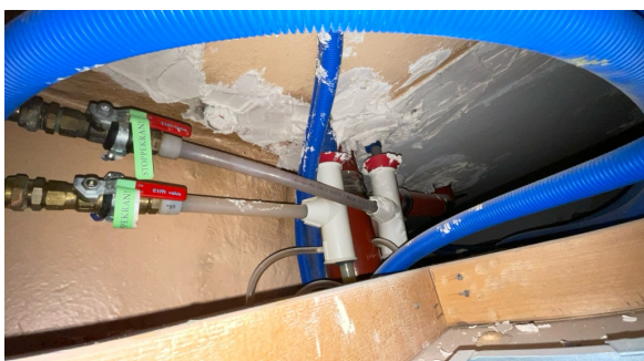
Soilrør/avløpsrør i rød farge bakerst på bildet.
