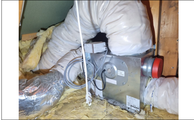
Ventilasjonsanlegg kald loft.
