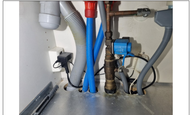
Rørpropp i kjøkkenbenk.
