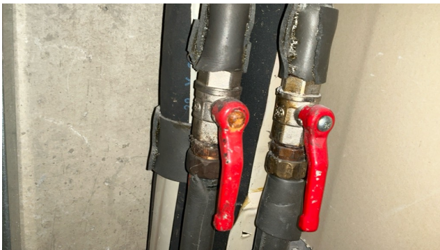
Hovedstoppekraner bak luke i vegg gang
