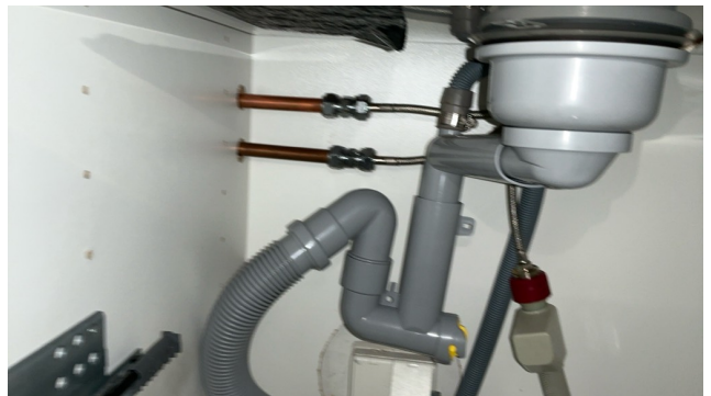
Avløp vask kjøkken
