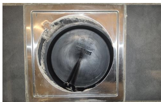
Avløp (inkl. sluk) - Sluk i dusjsone bad
