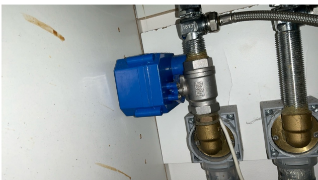
Magnetventiler automatisk vannstoppersystem i kjøkkenskap
