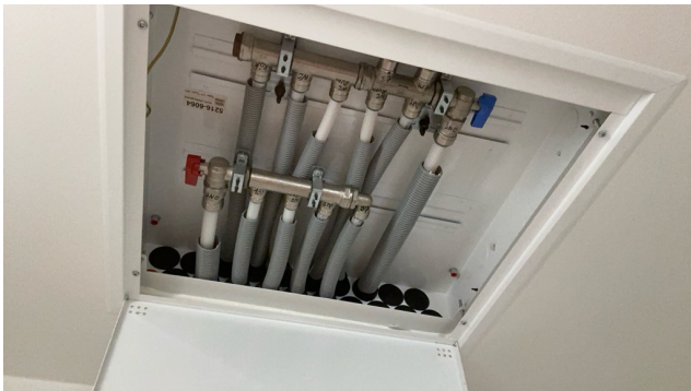
Fordelerskap i bad
