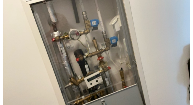
Fordelerskap med hovedstoppekraner
