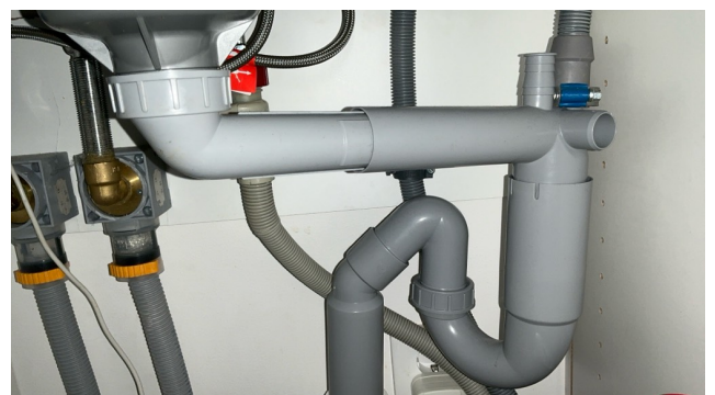
Avløp vask kjøkken
