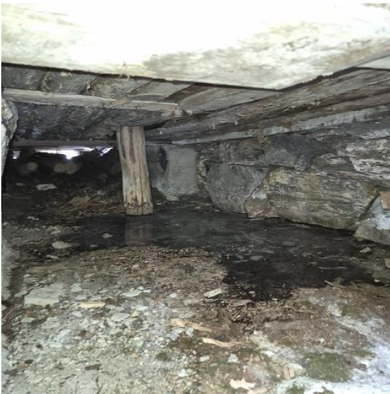
Kommentar - [Skader/avvik på utvendige flater/konstruksjoner 1]
