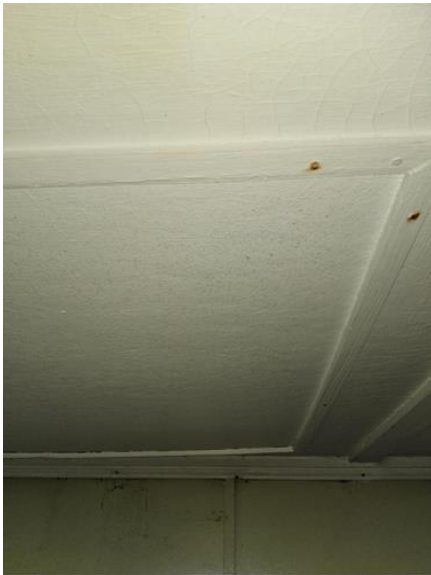
Kommentar - [Innvendige observasjoner/skader/avvik 6]
