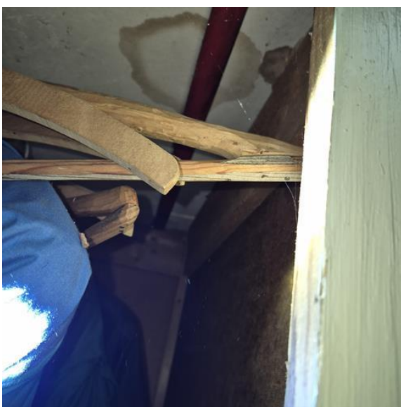
Kommentar - [Innvendige observasjoner/skader/avvik 2]
