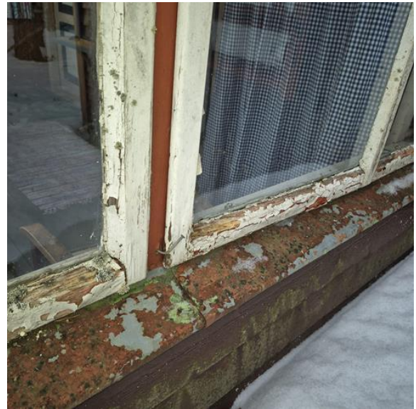
Kommentar - [Skader/avvik på utvendige flater/konstruksjoner 8]
