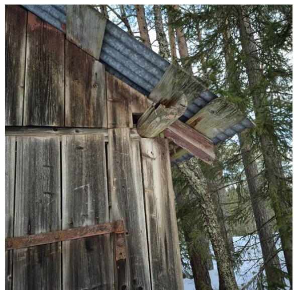
Kommentar - [Skader/avvik garasje 1]
