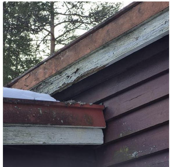
Kommentar - [Skader/avvik på utvendige flater/konstruksjoner 6]
