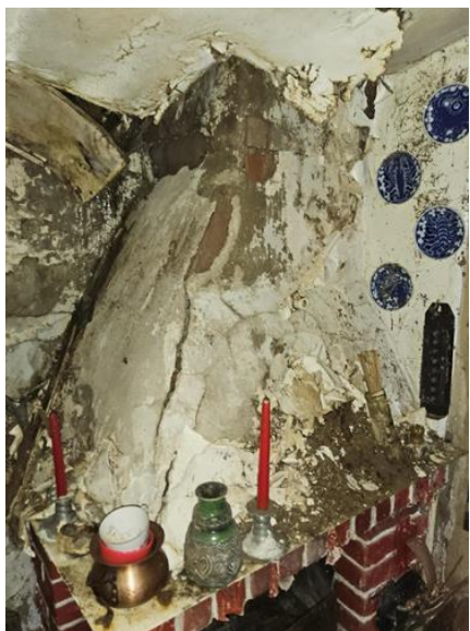
Kommentar - [Innvendige observasjoner/skader/avvik 4]
