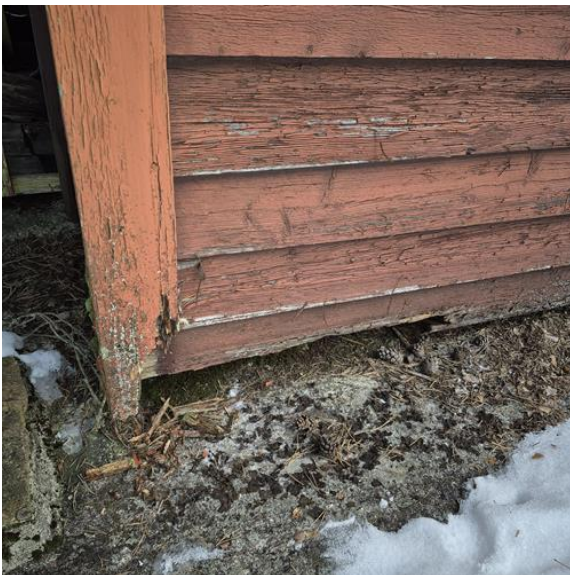
Kommentar - [Skader/avvik på utvendige flater/konstruksjoner 7]
