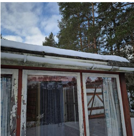
Kommentar - [Skader/avvik på utvendige flater/konstruksjoner 5]
