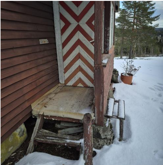
Kommentar - [Skader/avvik på utvendige flater/konstruksjoner 9]
