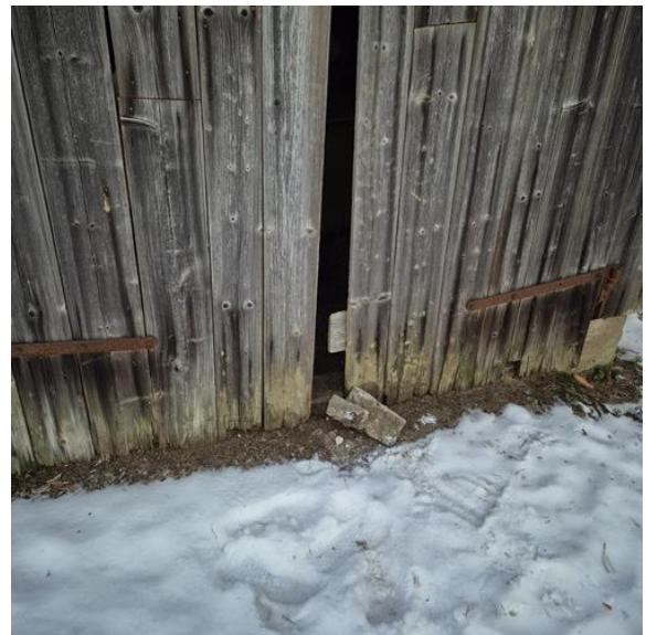
Kommentar - [Skader/avvik garasje 3]
