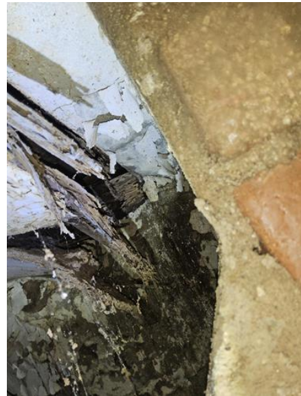
Kommentar - [Innvendige observasjoner/skader/avvik 5]
