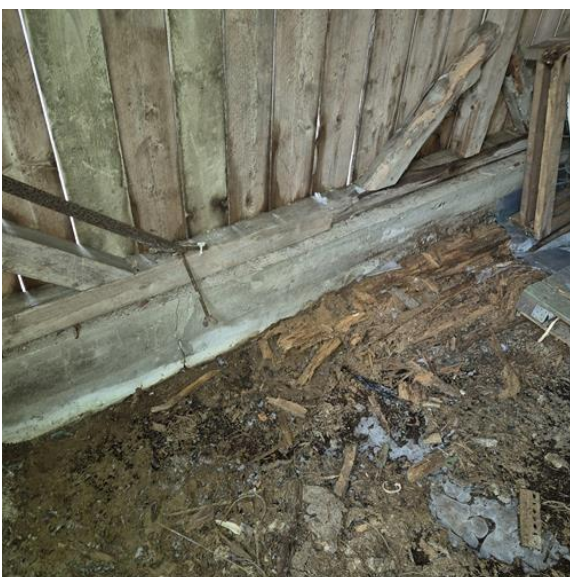
Kommentar - [Skader/avvik garasje 2]
