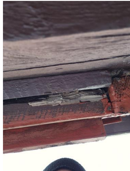
Kommentar - [Skader/avvik på utvendige flater/konstruksjoner 2]
