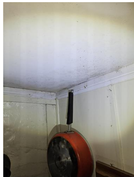
Kommentar - [Innvendige observasjoner/skader/avvik 3]
