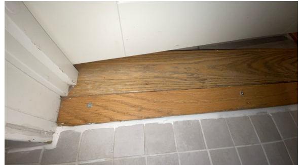
Luftespalte under dørrbladet.
