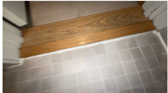
Liten sprekk i gulvlist (festet med skruer) har ingen praktisk betydning hverken for bruk eller vanntetthet.
