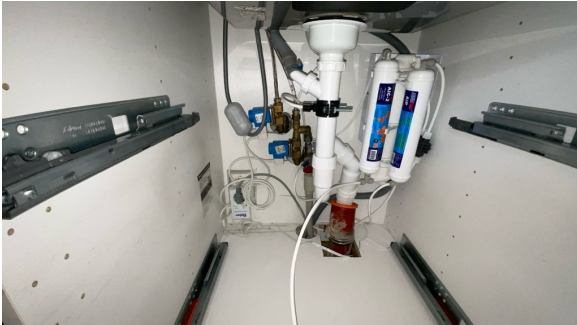
Lekkasjestopper på kjøkken. Synlig, nyere avløpsrør (rød farge).
