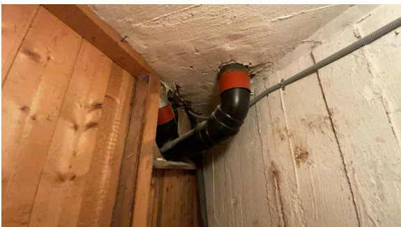
Avløpsrør i bod i kjeller.
