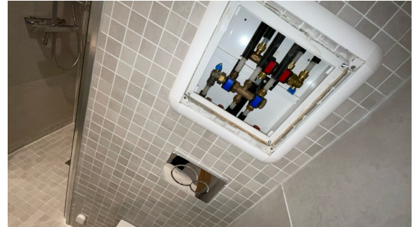
Fordelerskap i vegg og drensspalte (hvit) nederst på samme vegg.
