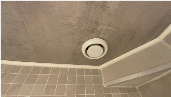
Lufteventil på bad.
