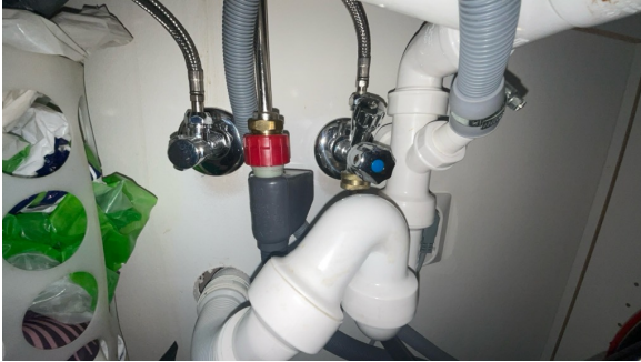
Stoppeventiler på kjøkken
