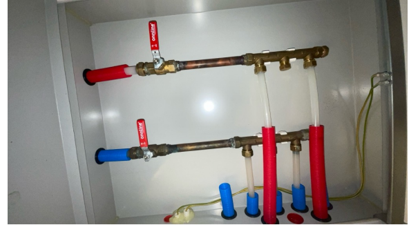
Fordeleskap på bad
