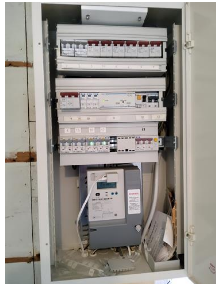
Elektrisk anlegg - [Sikringsskap.]
