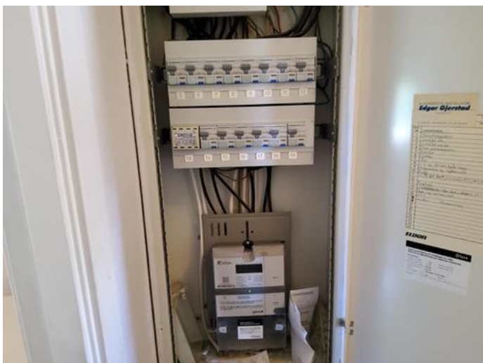
Elektrisk anlegg - [Sikringsskap]
