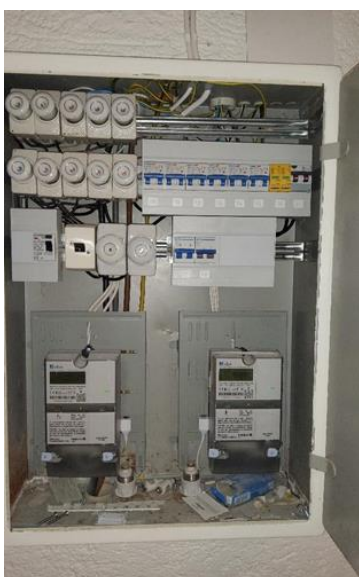
Elektrisk anlegg - [Sikringskap ]
