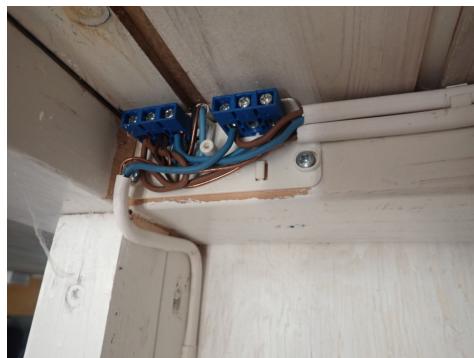
Åpen koblingsboks på toalettrom i kjeller.
