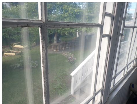
Vindu i entre, ytre del med 2-lags glass er punktert.
