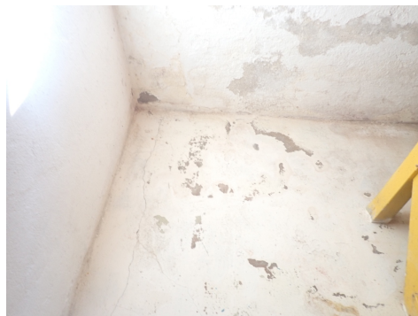
Div. riss og sprekk på gulv i vaskekjeller
