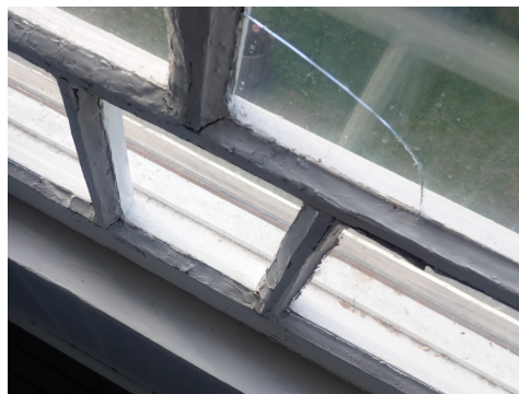
Vindu i entre er værslitt. Stekk i rute.
