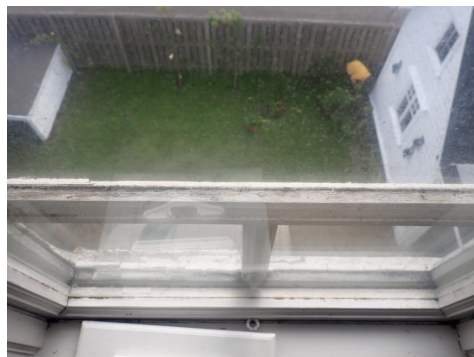
Vindu på loft mot øst er værslitt.
