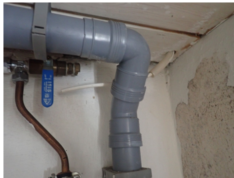
Løs ledning på toalettrom i kjeller.
