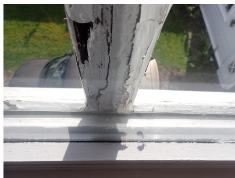
Vindu på kjøkken- råte i sprosset.
